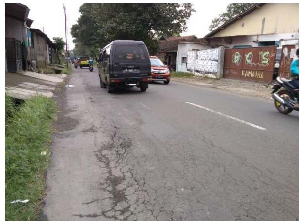
Kerusakan Jalan. Sumber:Foto Pribadi
