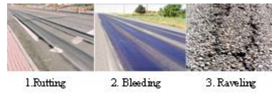
Gambar 1. Tipikal kerusakan jalan.
